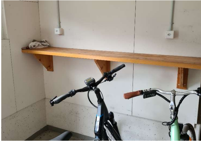
Bild 8 Steckdosen im Veloraum
